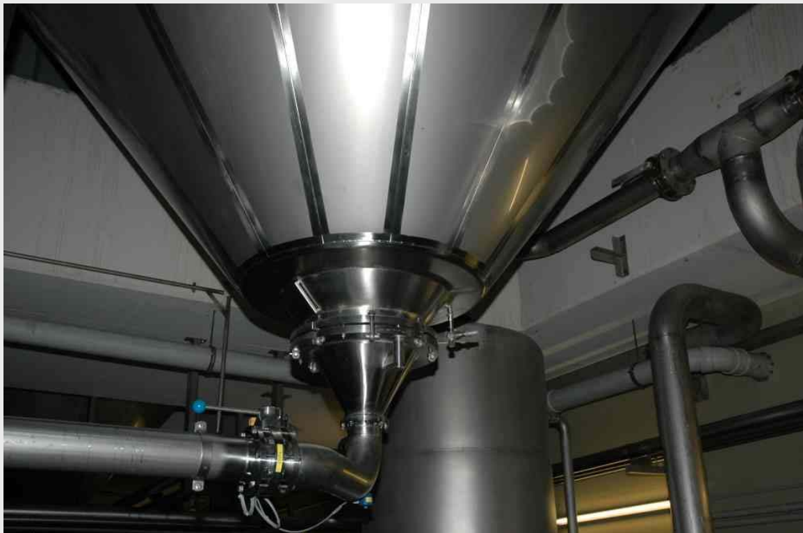
Cono de tanque
