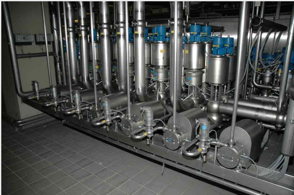
sala de tanques - extracción de muestras
