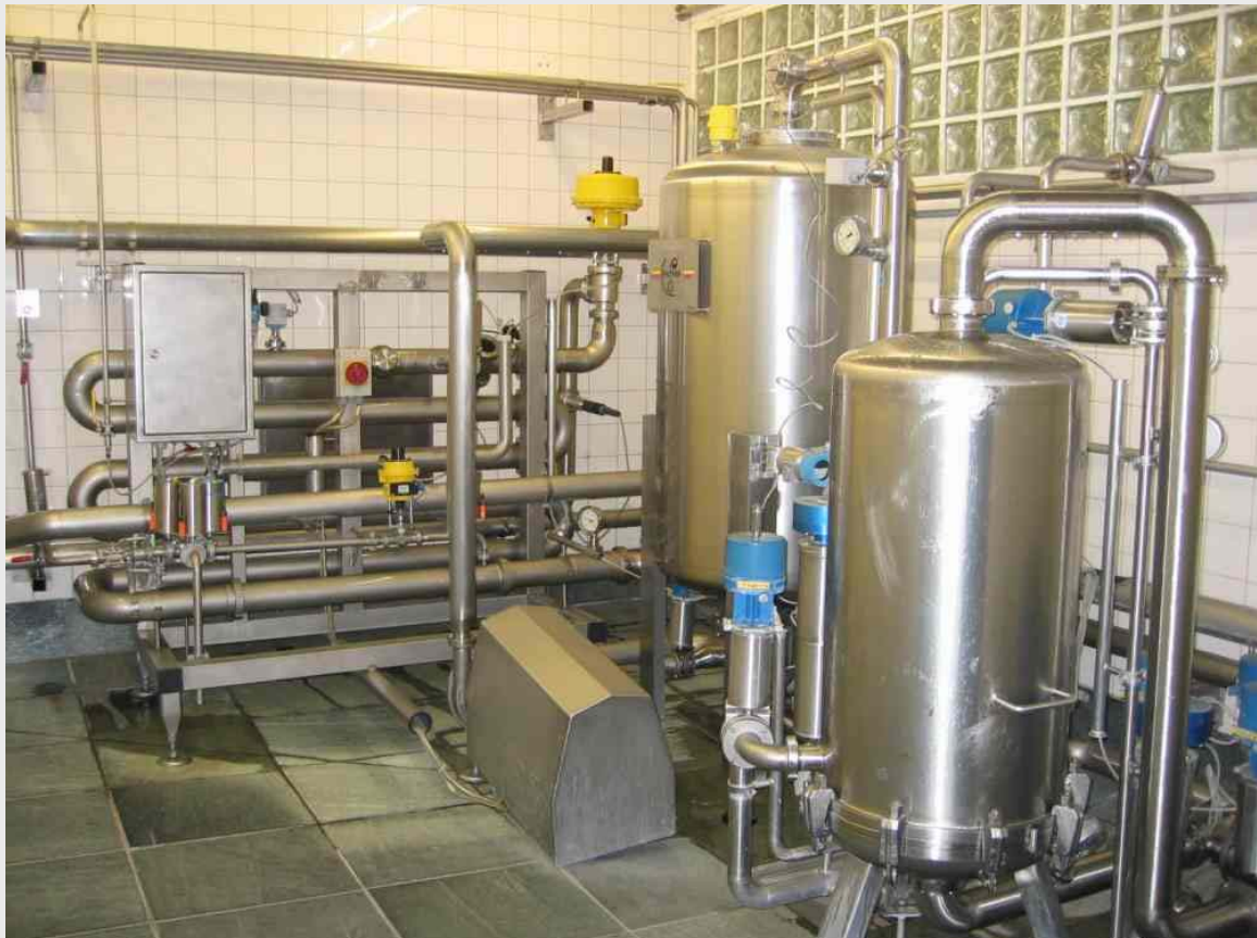
Filtro Trap, tanque de bufer y carbonización CO 2
