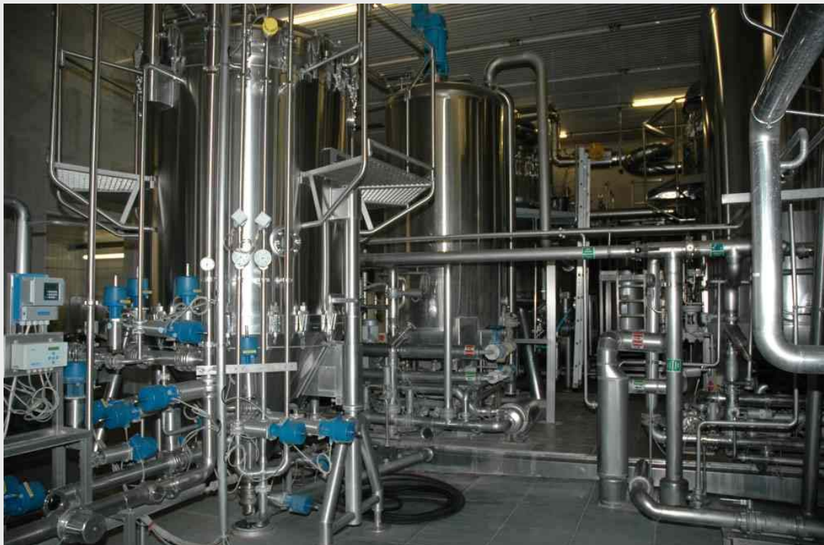
Línea de filtración
