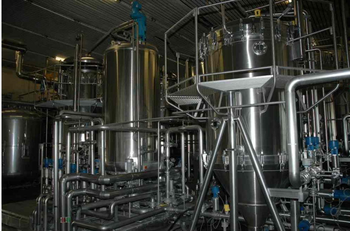
Línea de filtración
