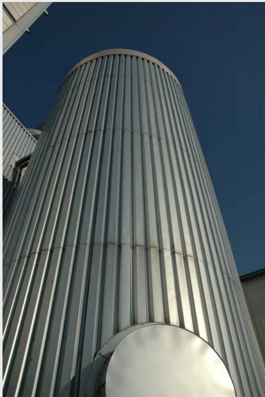
Tanque de deposito de CO 2
