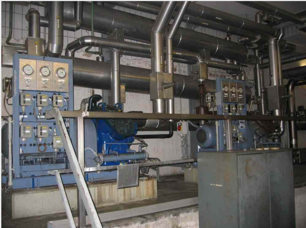
Equipo de refrigeración
