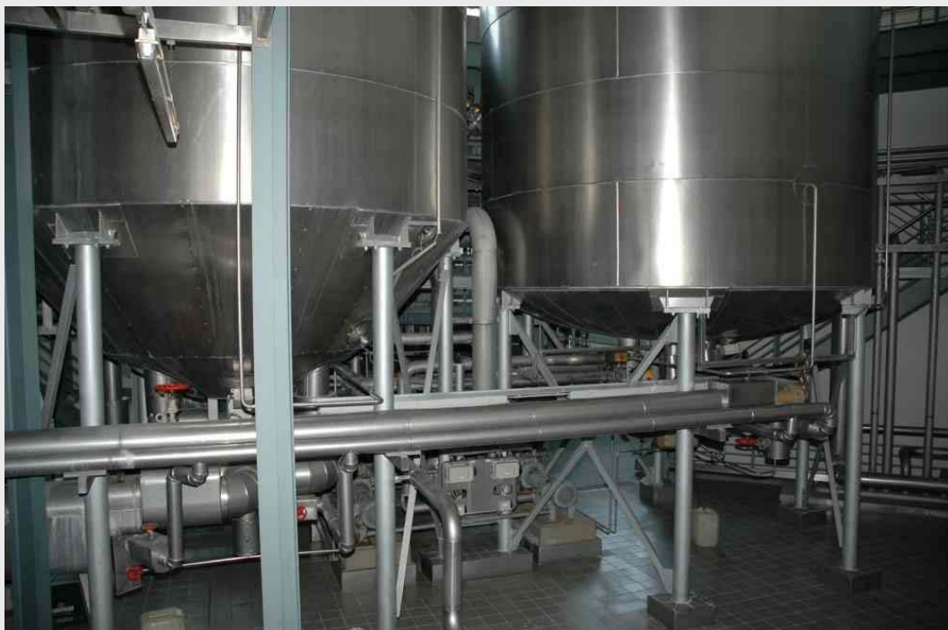
Заторный котел и кипяtitель
