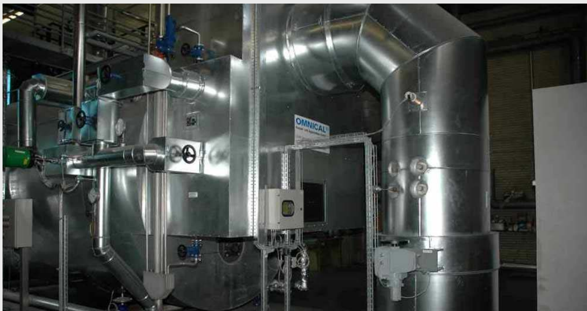
Generador de vapor 18 toph
