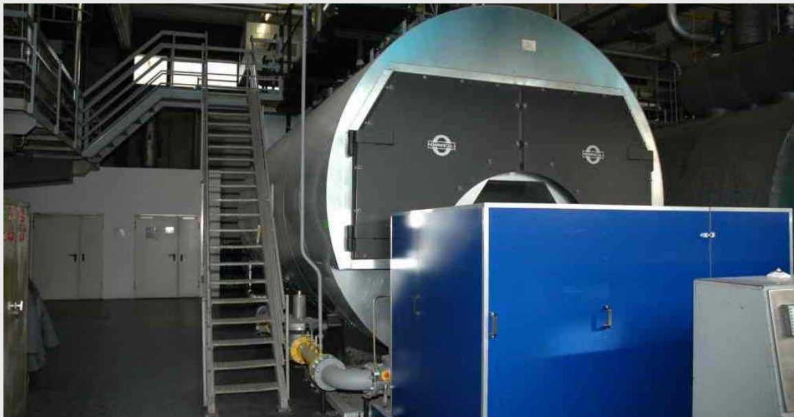
Generador de vapor 18 toph
