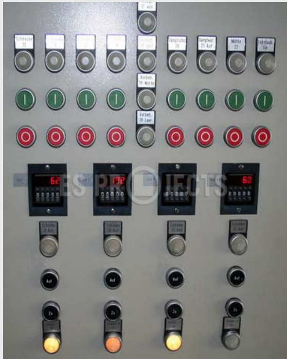
Armoire électrique - Traitement de malt
