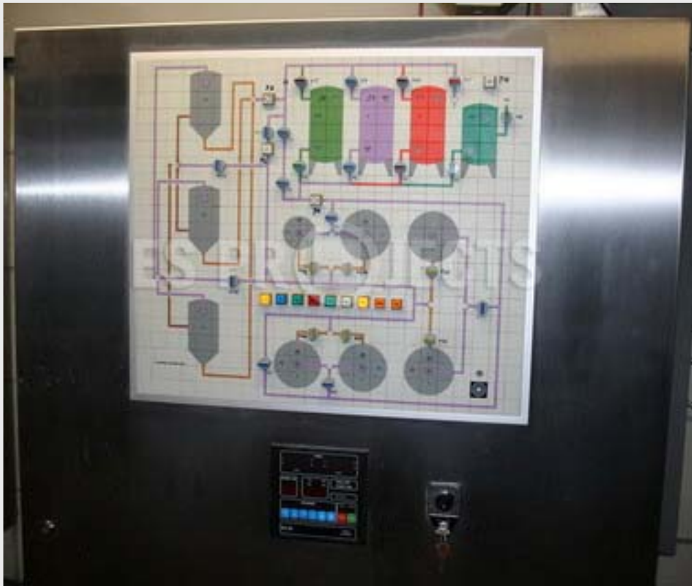
Armoire électrique NEP
