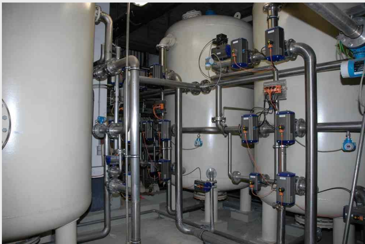
Установка для обезжелезивания
