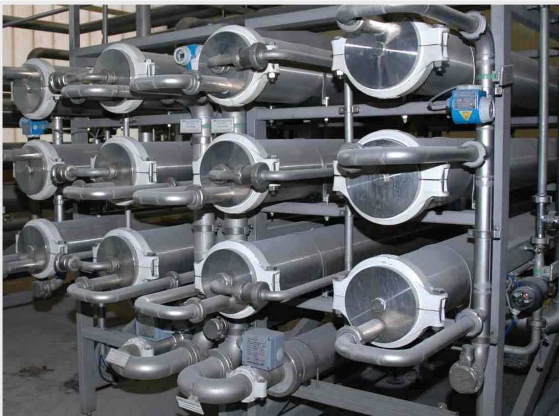
2 модуля осмосной установки
