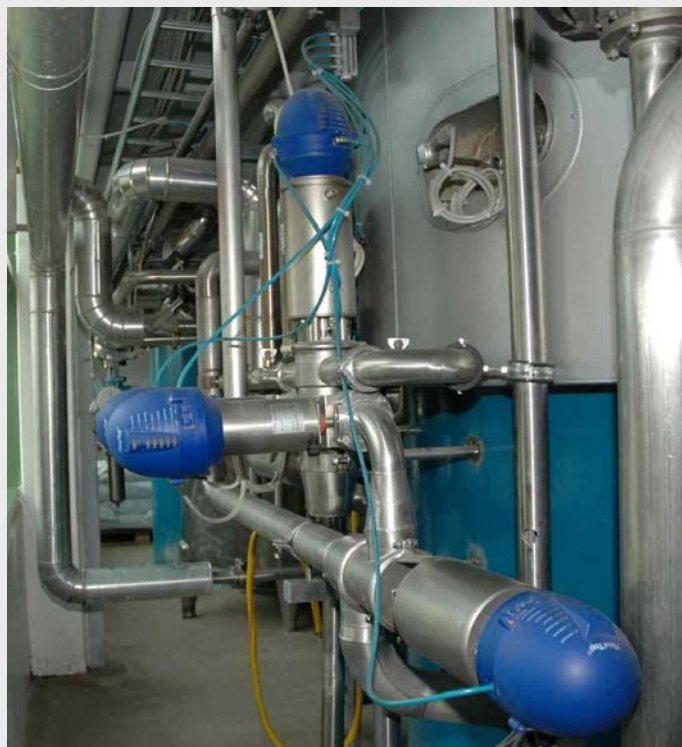
Sala de cocimiento – varias válvulas
