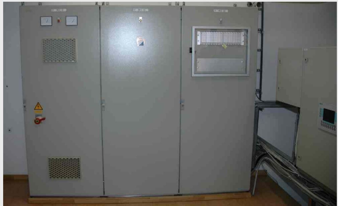
Centro de control
